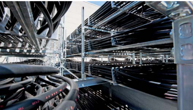
Der Solar-/Luftabsorber entzieht Umgebungsluft und Sonne die Energie, um daraus Wärme und Kälte zu erzeugen.
