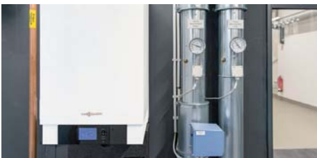
Das Vitodens 200-W Gas-Brennwertgerät deckt die Spitzenlasten ab.
