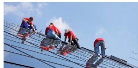
Dach mit Doppelfunktion: Unter den PV-Modulen sind die Leitungsstränge des Solar-Luftabsorbers verlegt.
