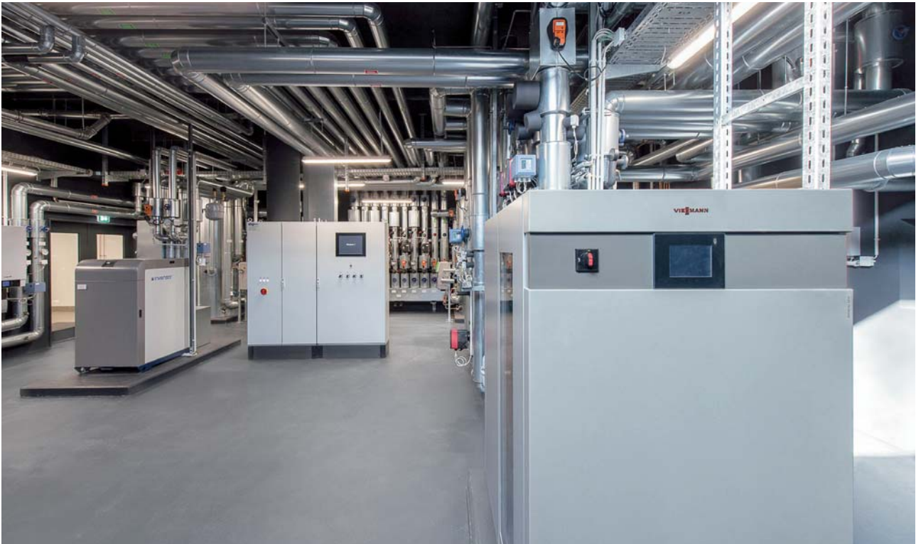
Die Großwärmepumpe Vitocal 300-G Pro hat eine Heizleistung von 82,8 kW.
