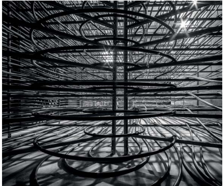
Das Wärmetauschersystem sorgt für kontrolliertes Einfrieren.
