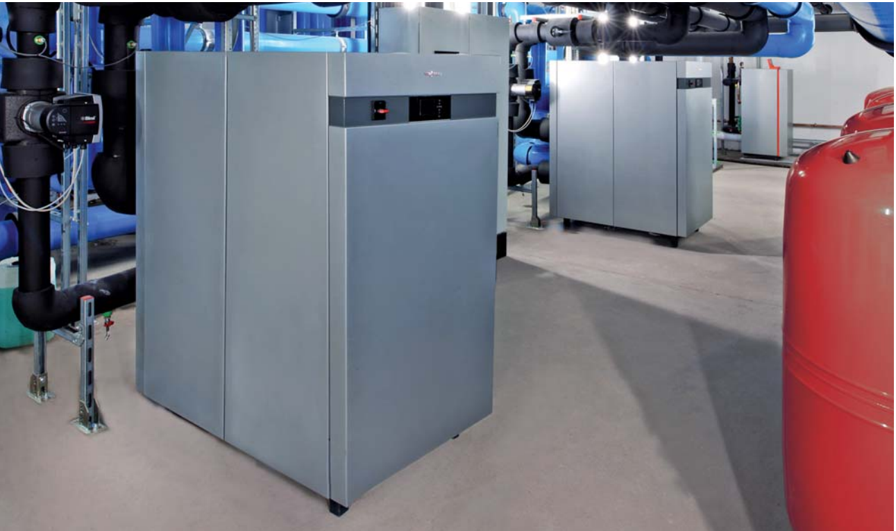
Zwei Wärmepumpen Vitocal 300-G Pro mit je 120 kW Leistung, im Hintergrund ein Gas-Brennwert-Spitzenlastkessel Vitocrossal 300.
