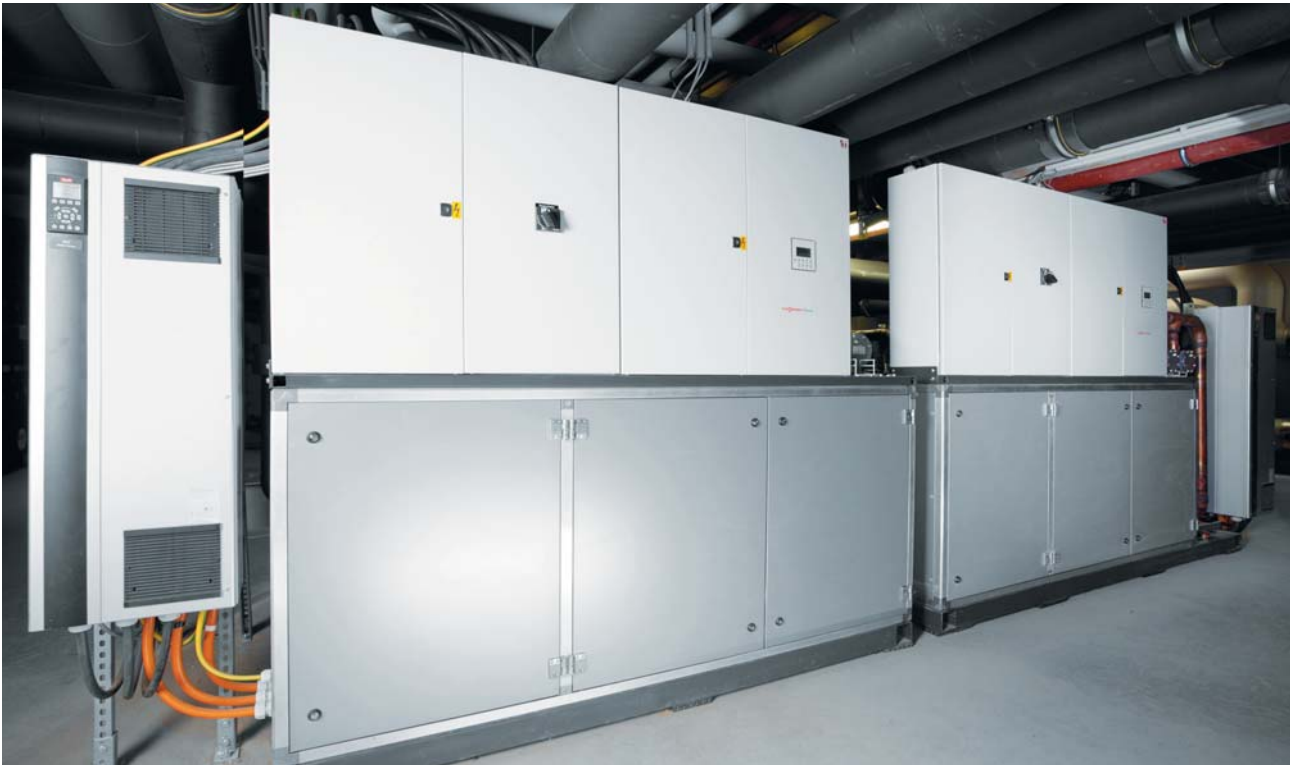
Die KWT-Wärmepumpen haben eine Leistung von 720 kW.
