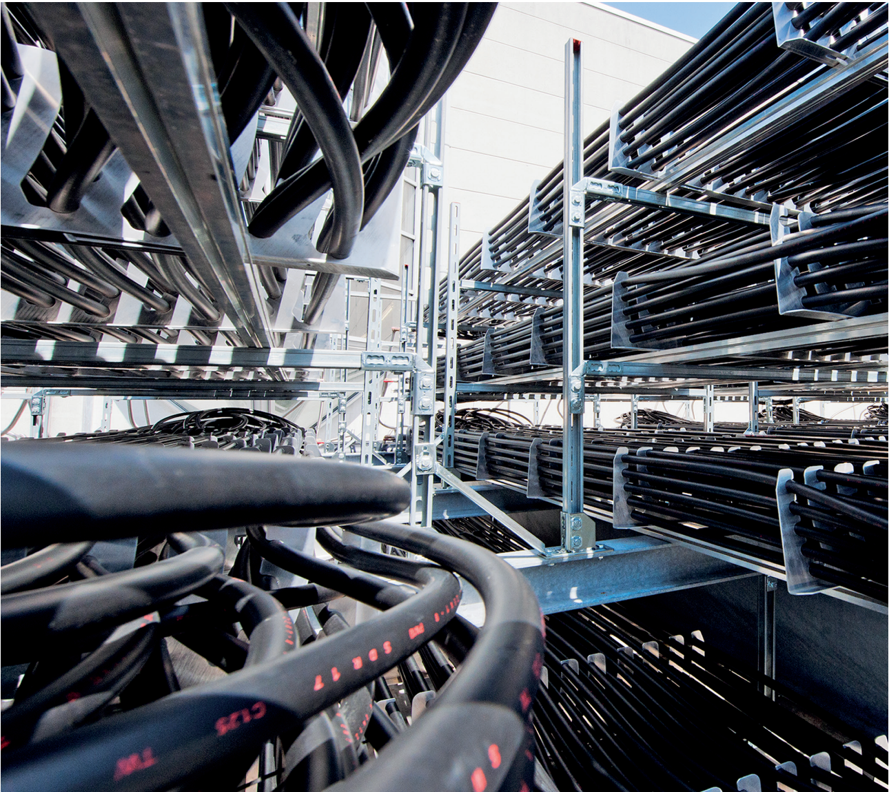
Der Solar-Luftabsorber entzieht Umgebungsluft und Sonne die Energie, um daraus Wärme und Kälte zu erzeugen.
