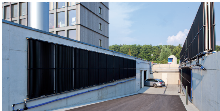
Platzsparender Solar-Luftabsorber-Zaun an der Einfahrt zur Tiefgarage des Hochhauses
