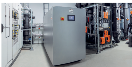
Wärmepumpe Vitocal 300-G Pro mit einer Leistung von 140 kW
