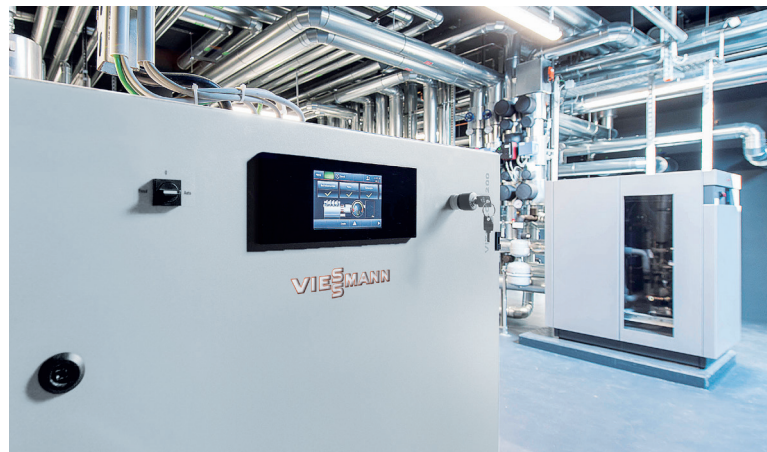
Das Blockheizkraftwerk Vitobloc 200 hat eine Leistung von 6 kW el und 15 kW th .
