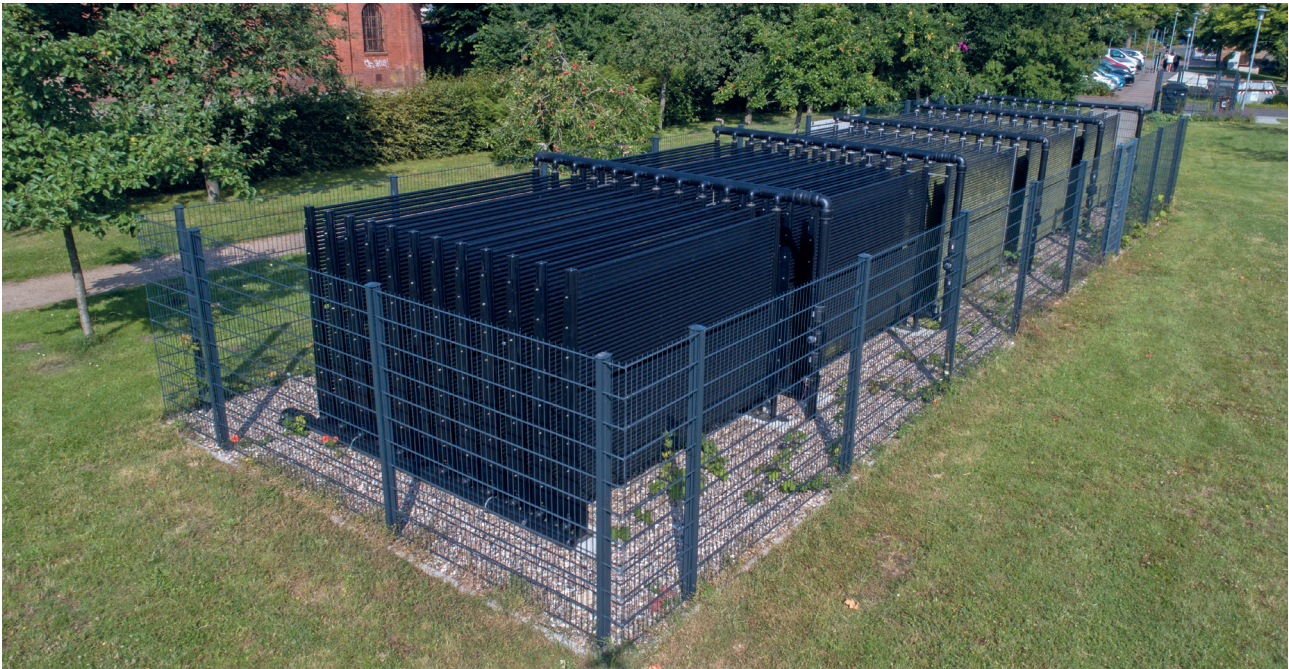
Eine platzsparende Lösung für Solar-Luftabsorber ist der Energiezaun.
