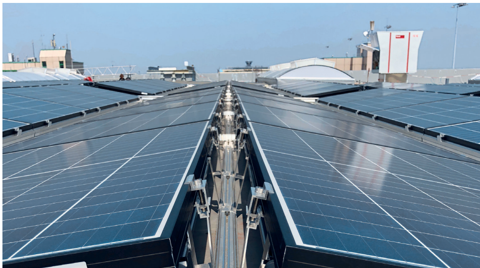
„Kraftdach“ mit kombinierten Photovoltaik-Modulen und Solar-Luftabsorbern
