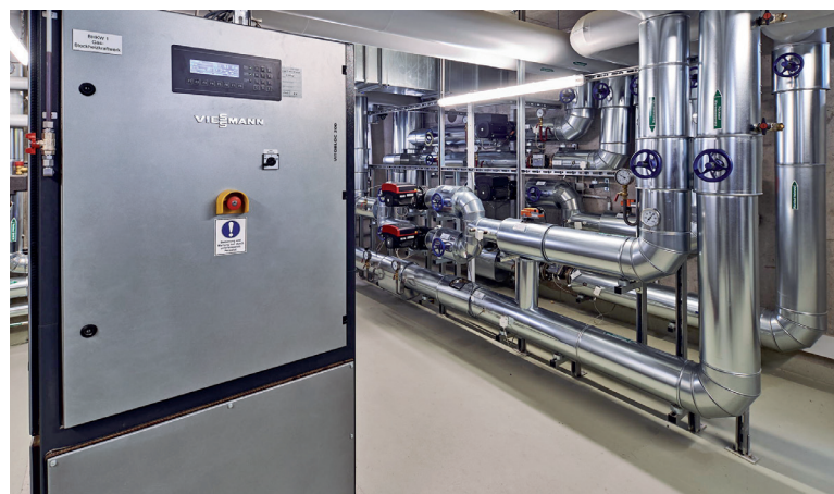
Das Blockheizkraftwerk Vitobloc 200 liefert den Strom zum Betrieb der Wärmepumpe.
