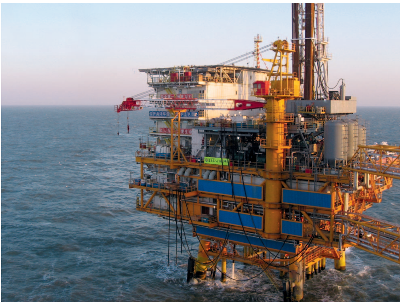
Auf der Ölproduktionsplattform CNOOC LUDA 27-2 sorgen zwei RGMS70/2 Brenner mit digitalem Feuerungsmanagement für die nötige Prozesswärme
