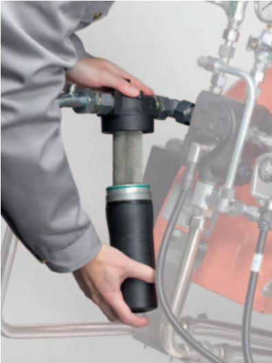
Der integrierte Ölfilter ist leicht zugänglich (bei MS Brenner Ausführung unterschiedlicher MFO-Brennstoffe im Wechselbetrieb serienmäßig)
