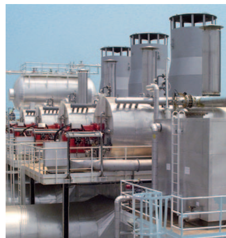
Vier RGL 70 Brenner stellen über Thermoölkessel die Pumpfähigkeit des Rohöls sicher
