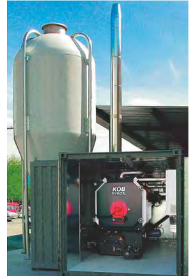
Mobile Wärmezentrale im Container (Hochsilo als Pelletlager)
